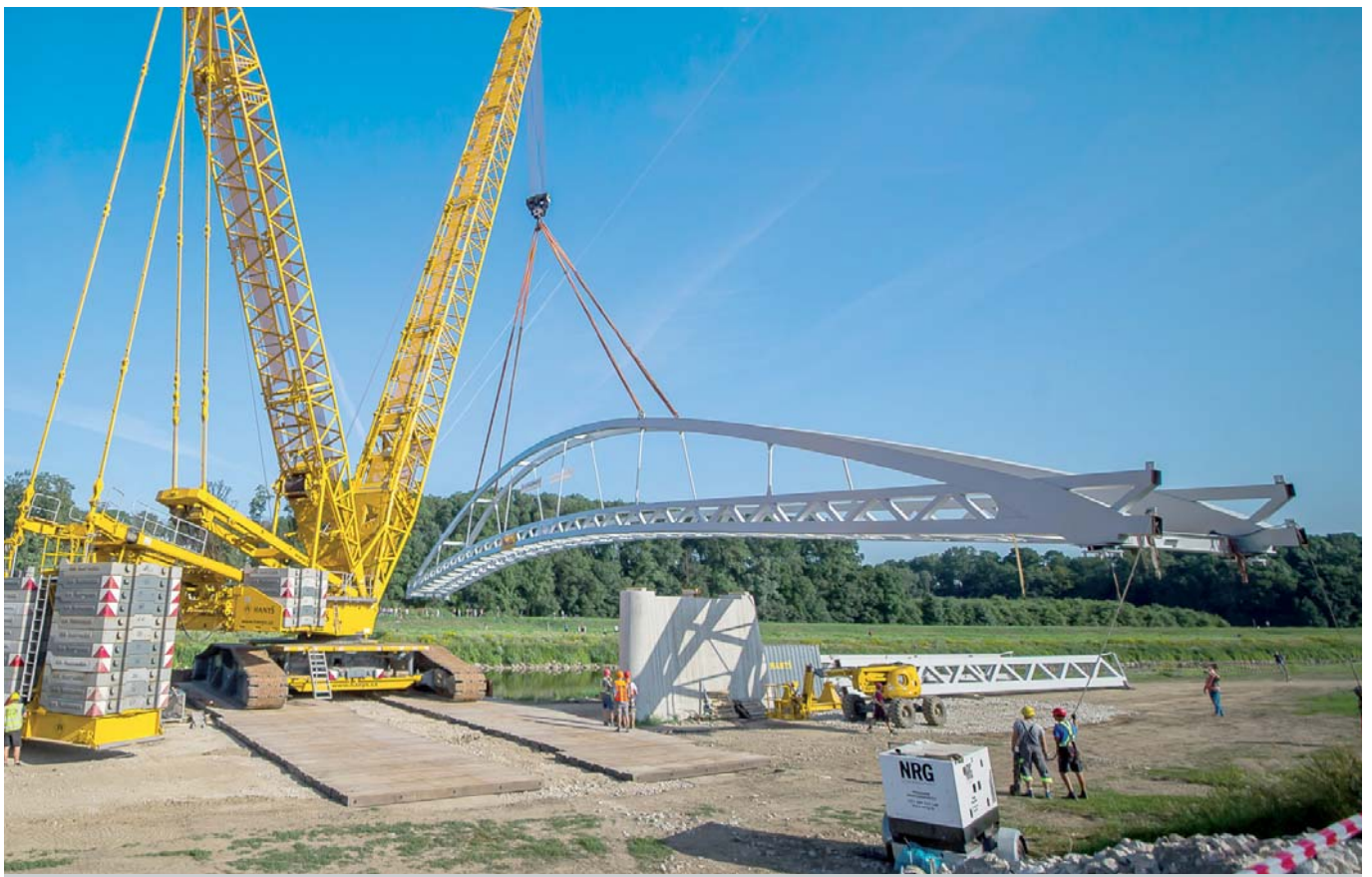
Položenie 143-metrovej lávky nad riekou bol náročný technologický proces, ktorý si vyžadoval mimoriadnu presnosť a prípravu.
